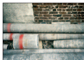
© INRS Canalisation en amiante
