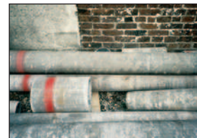
© INRS Canalisation en amiante ciment
