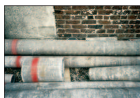
© INRS Canalisation en amiante ciment
