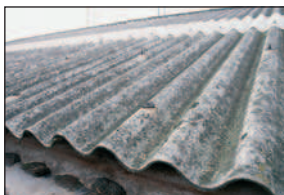
Crédits : INRS Toiture en amiante ciment
